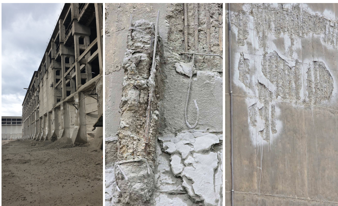
Фиг.4: Съществуващата сграда с изпълнени локални усилвания в слабите места на конструкцията и фрагменти от дефекти в армирането на комина
